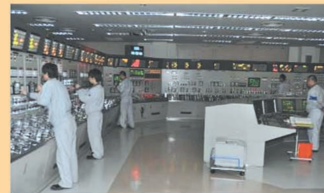
全ての外部電源喪失を想定した運転操作訓練(シミュレーター室)
