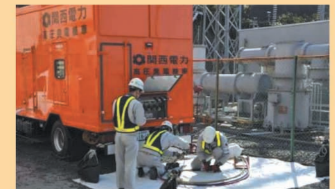
電力会社から借用し配備した電源車へつなぎこむ訓練
